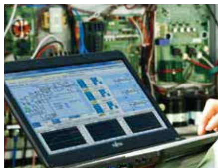
Supporto alla messa in servizio
